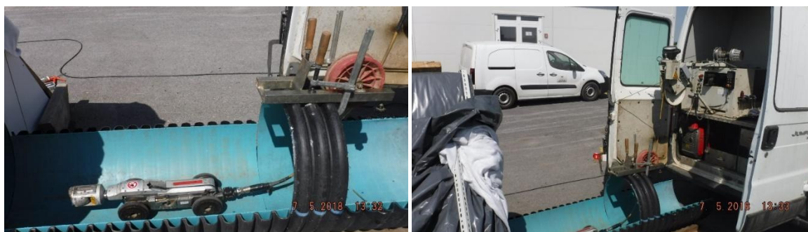
Slika – Oprema za ispitivanje i vizualno kodiranje stanja snimanjem daljinski upravljanom CCTV kamerom u vlasništvu Međimurskih voda d.o.o.
